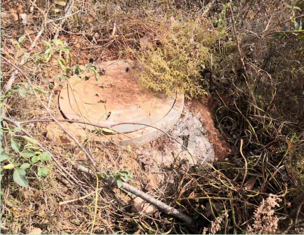
现场图片-蓄水池控制井
